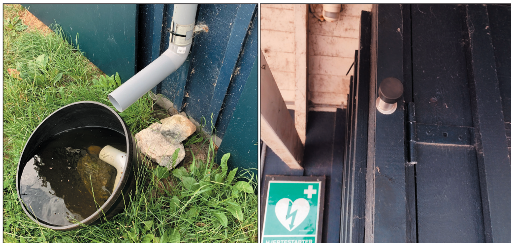
Nedløbsrøret endte i jorden og er nu erstattet af en Storm P-løsning. th. dørstopperen.
