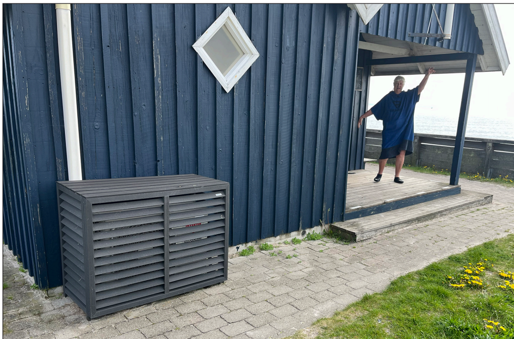
Varmepumpen blev i marts 2023 forsynet med en udvendig beskyttelseskasse.
